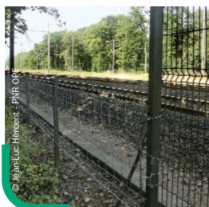
Ancienne clôture (2 m de haut) et nouvelle spéciale faune (1,2 m) avec son espace de circulation de 40 cm au sol.
